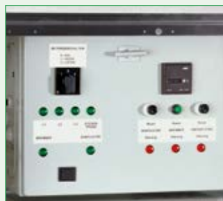
Schaltkasten mit Betriebsstundenzähler, geschützt eingebaut
